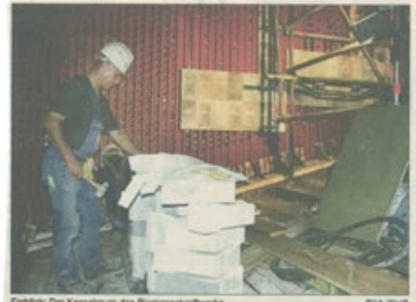
Blick: Der Kesselraum des Biomassekraftwerks. Bild: Weiß
